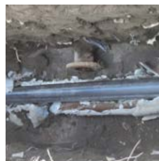
Rompimiento de Tubería Existente
