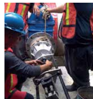
Instalación del taladro neumático con broca de corona de 12", a la válvula de compuerta de 12" Ø, instalada en la TEE partida de acero y perforación con taladro neumático de 12", en la tubería de concreto de 48" de Ø, sin interrupción del servicio.
